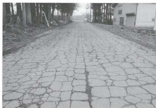
凍上災害によりひび割れた町道
