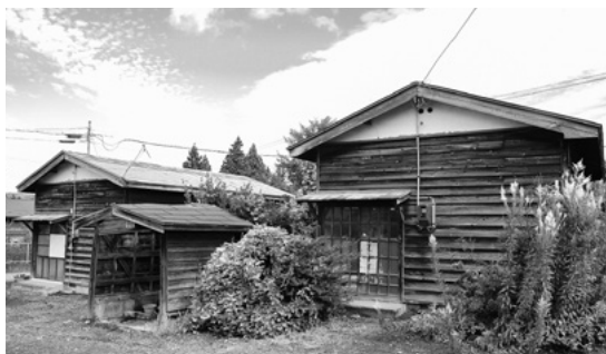
老朽化・解体の進む町営住宅
