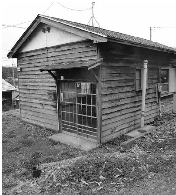
老朽化している町営住宅
