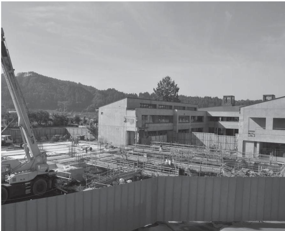
三戸小学校の校舎に接続して建設されている高等部校舎
